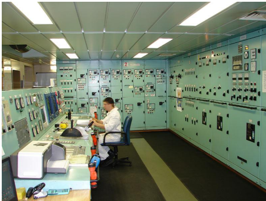
Figura 8: Praça de Controle de Máquinas ( Engine Control room ).
