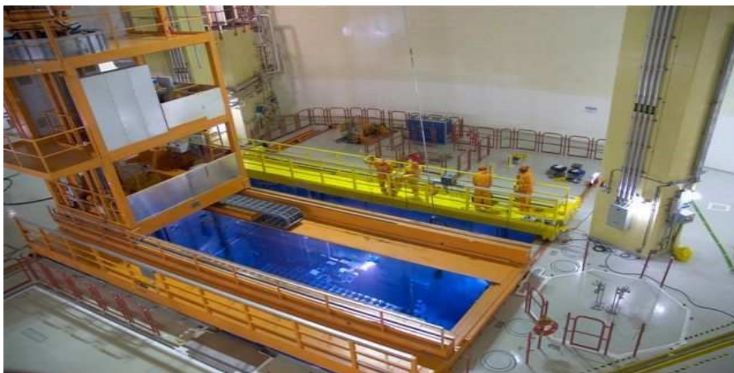
Figura 12 Piscina de armazenamento de combustível irradiado
