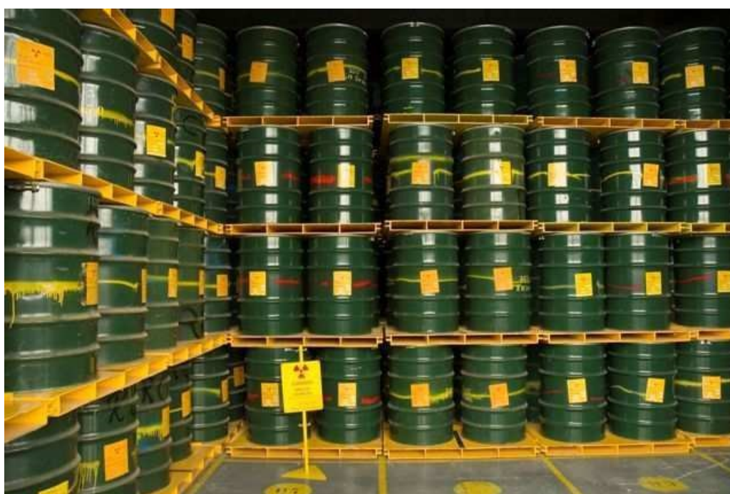
Figura 8 Armazenamento de rejeitos radioativos em tambores
