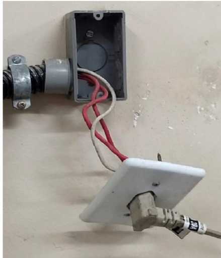
Figura 6 - instalação elétrica do ar condicionado
