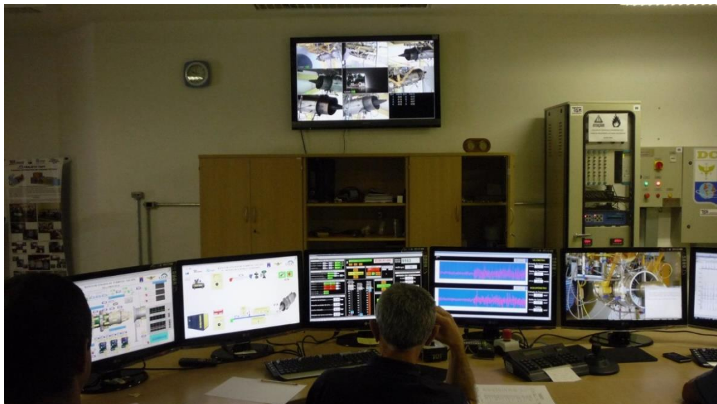
Figura 1 Sala de controle do Banco de ensaios da TAPP
