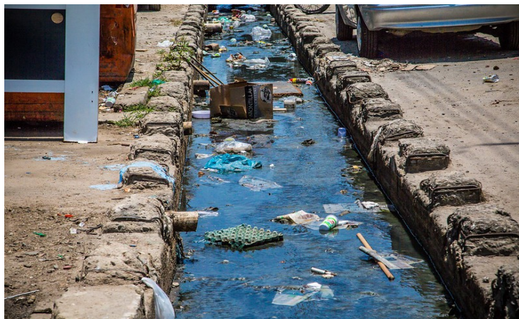
Rede de esgoto – Maré (Rio de Janeiro)
