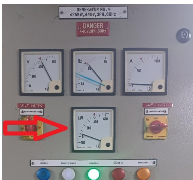
Figura 12: Painel monitoramento gerador 4 às 10:00 horas
