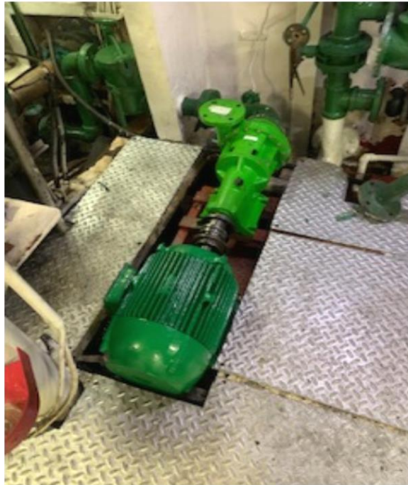
Figura 51 – Conjunto bomba e motor elétrico da BI de uma EDCG
