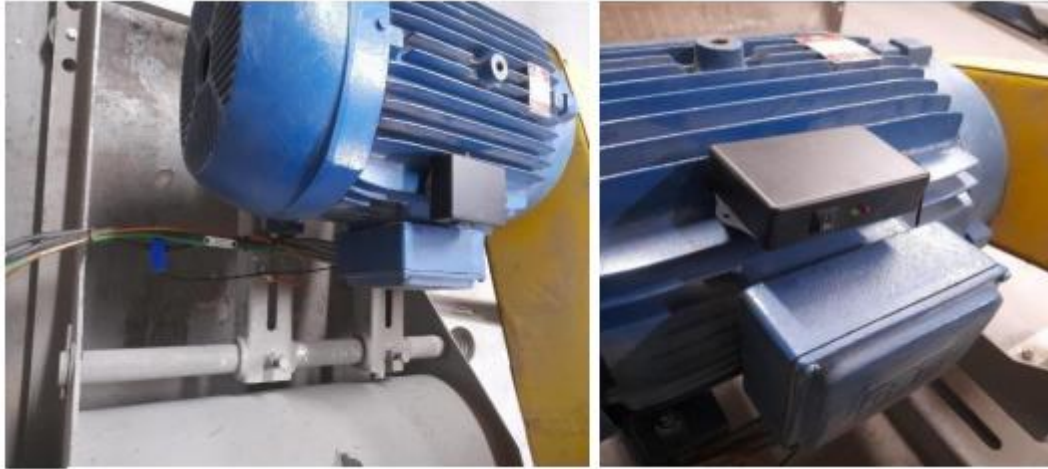
Figura 53: Protótipo instalado, pronto para uso. IDE: Fasso 02
