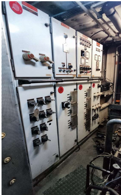
FIGURA 17 – QUADRO ELÉTRICO AUXILIAR
