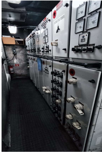
FIGURA 16 – QUADRO ELÉTRICO PRINCIPAL
